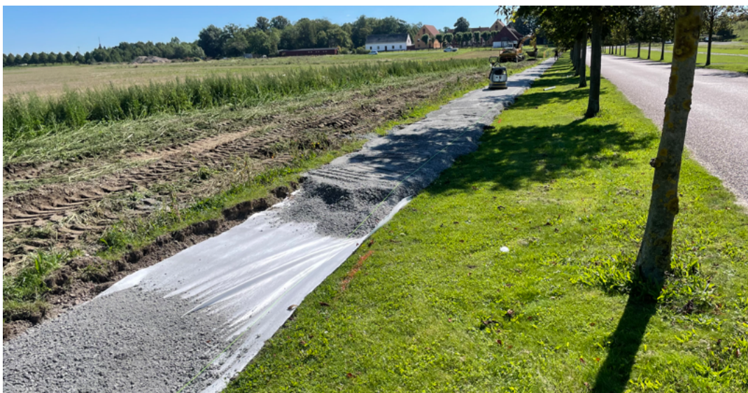
230904 Gångvägen utmed Katrinetorps allé görs om och lämnas över till AFOM för skötsel.
