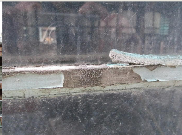
Nyare prov taget på fönsterkitt
