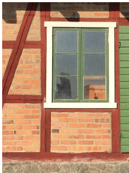
Figur 12. Snickerier i grönt, blått och vitt skapar tillsammans med det röda korsvirket ett karaktärsfullt uttryck.
