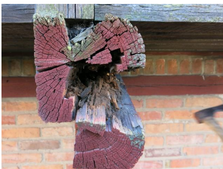
Figur 23. Allvarliga rötskador finns på loftgångarna. Foto 2017. Restaurera AB.
