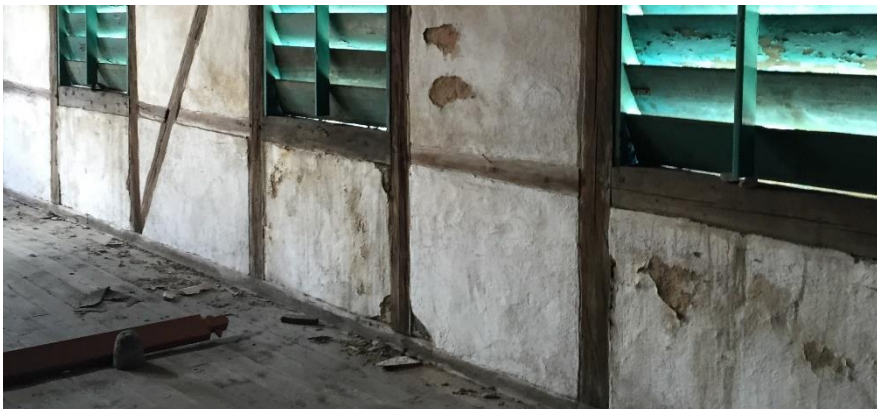
Figur 25. Delar av väggarna behöver putsas om interiört.
