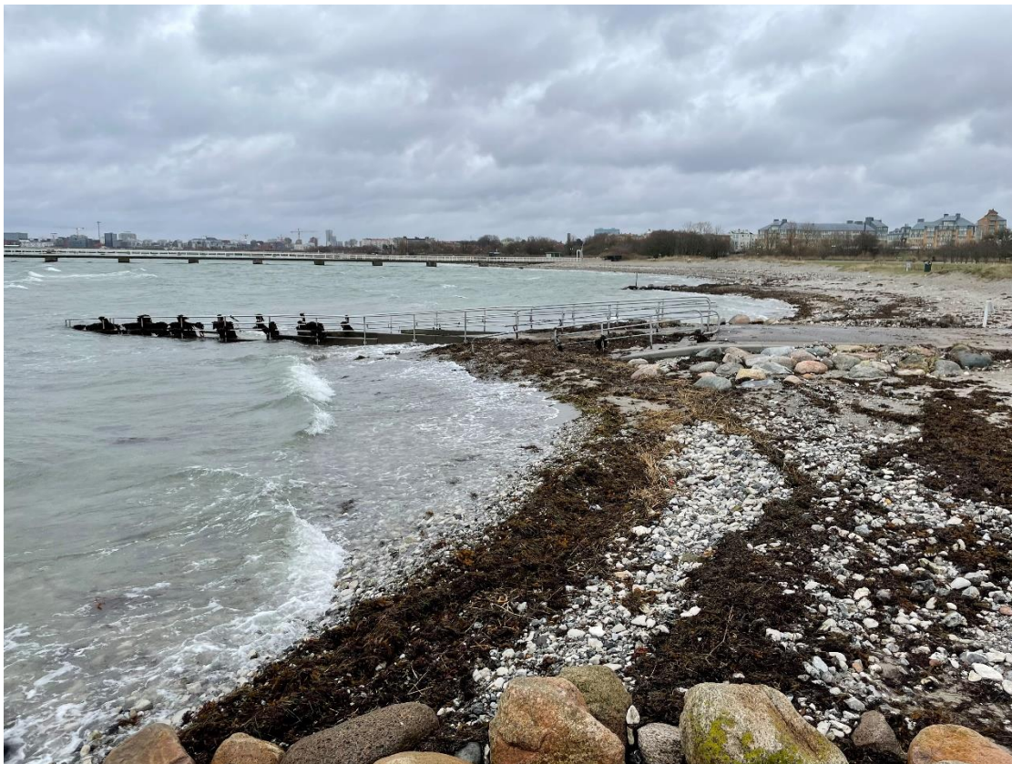
Nulägesbild 2023 Erosionsskador nedströms pga. befintlig ramp
