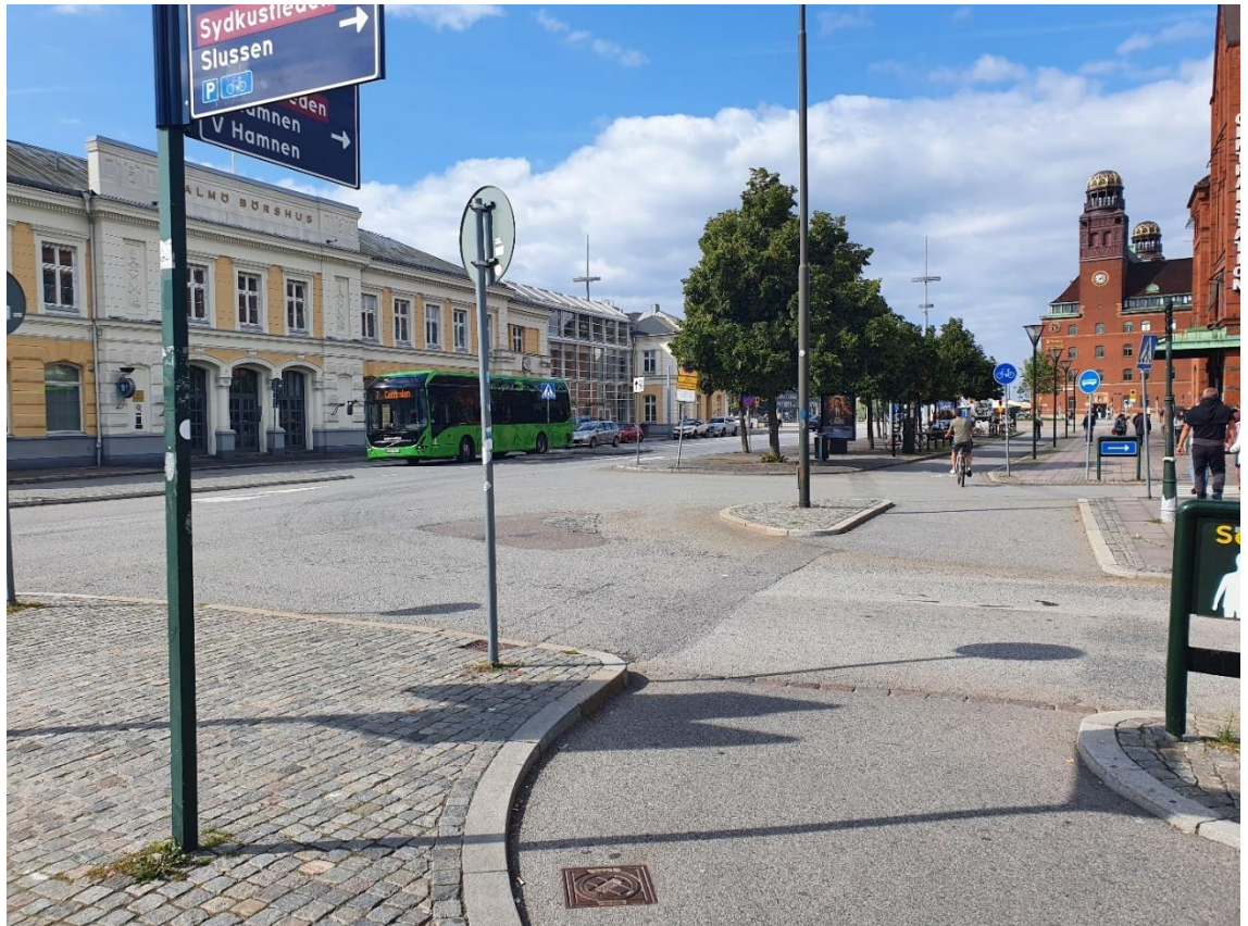
Figur 140. Korsningen Centralplan – Skeppsbron, spårbildning och ojämnheter i asfalten i södra körfältet.
