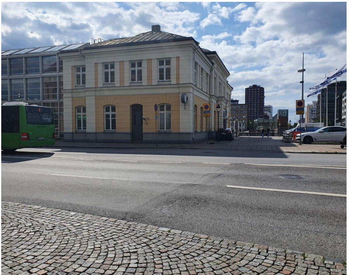
Figur 139. Spårbildning i asfalten på Skeppsbron.
