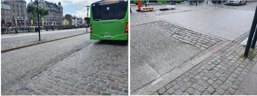
Figur 138. Till vänster: Ytskador och ojämnheter på Centralplans södra körbana. Till höger: Ytskador vid hastighetssäkerad passage på Centralplans södra körbana.
