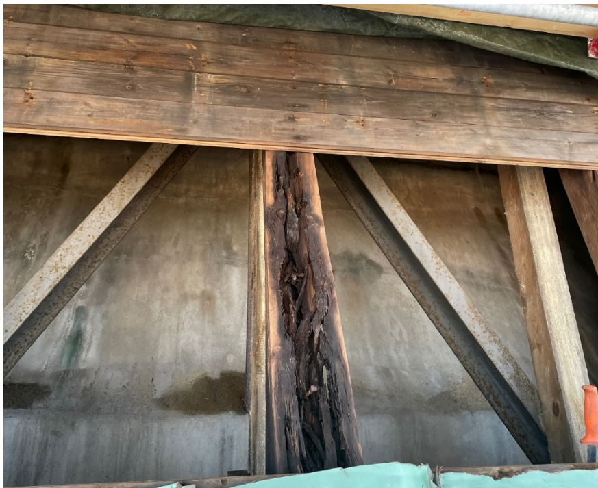
Figur 3 Takets trä och stålkonstruktion, träkonstruktionen visar friska takstolar och råspont, brevid murkna takstolar
