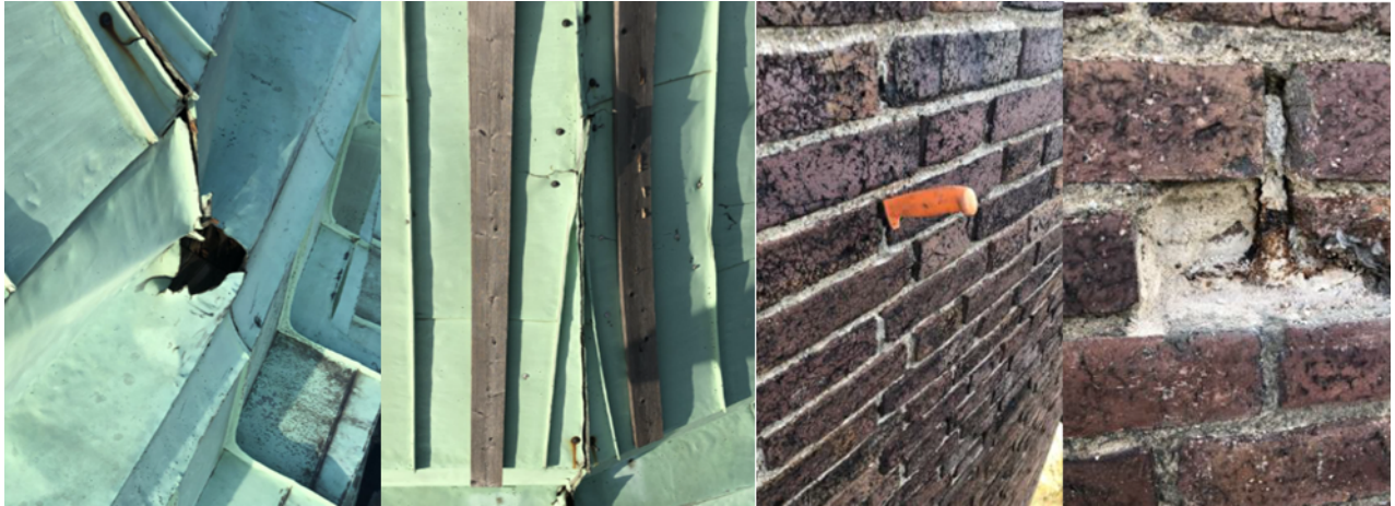
Figur 3 Hål i kopparplåt, bristfällig lagning av taket samt behov av omfogning av fasad.
