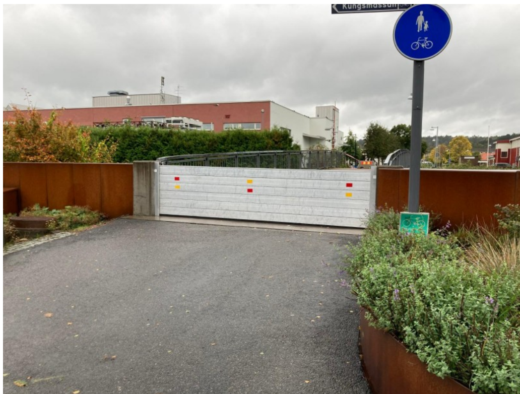
Exempel på översvämningsskydd i form av rörlig lucka i anslutning till ett brofäste till en bro över Kungsbackån i Kungsbacka kommun. Luckan kan öppnas och stängas vid behov. (Fotograf: Charlotte Bourghardt.)
