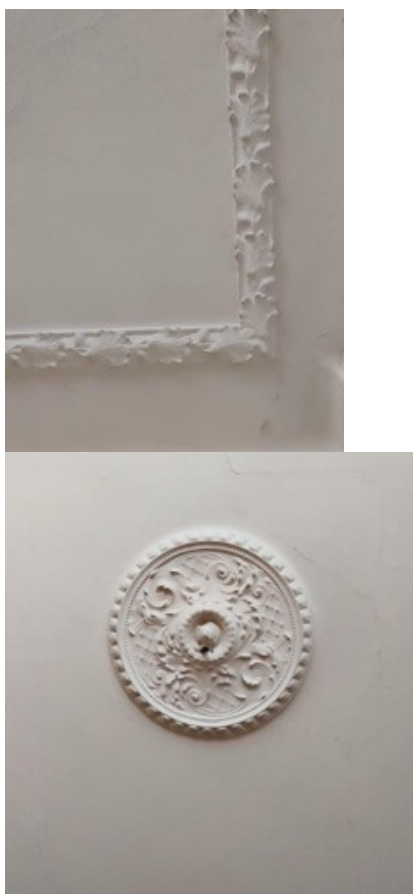
Exempel på renoverad takstuckatur som har monterats ner, gjutits av och kompletterats med nytillverkade.
