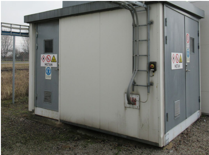
Bild över anläggningens elrum. Det är ca 25–30 cm upp till kant in till elrummet. Anläggningen påverkas inte av vatten innan det når upp till denna nivå. Vid ett intrång av vatten försätts anläggningen automatiskt i felsäkert läge. Foto: St1.
