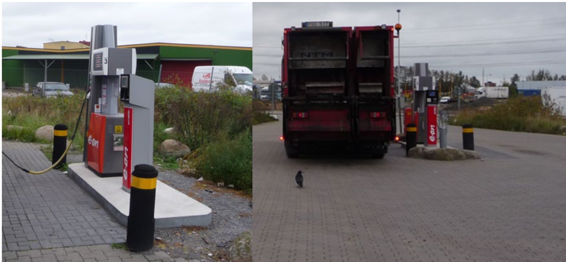
Bild över anläggningens nordvästra och södra del. Singeldispenser i nordväst (tv) och dubbeldispenser mitt i vändplanen (th). Anläggningens ventiler är täta både under och ovan mark för att förhindra eventuella gasläckage. Foto: St1.
