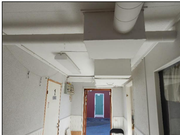
Hall och ventilation
