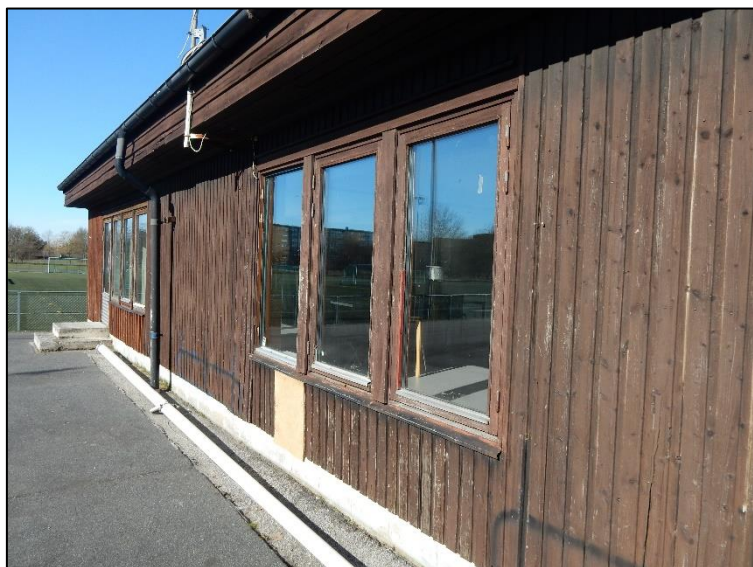
Fasad med fuktskadat virke
