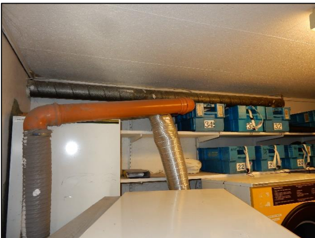
Tvättmaskin ej fackmannamässig påkopplad
