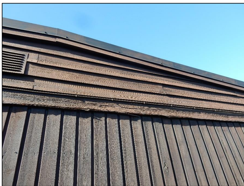
Uttjänt samt fuktskadad träpanel
