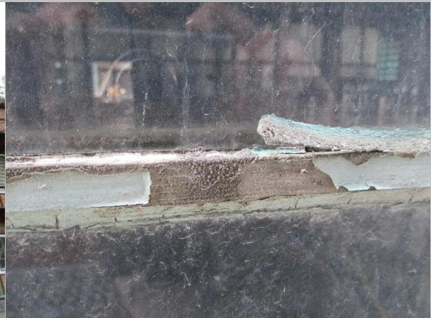
Nyare prov taget på fönsterkitt
