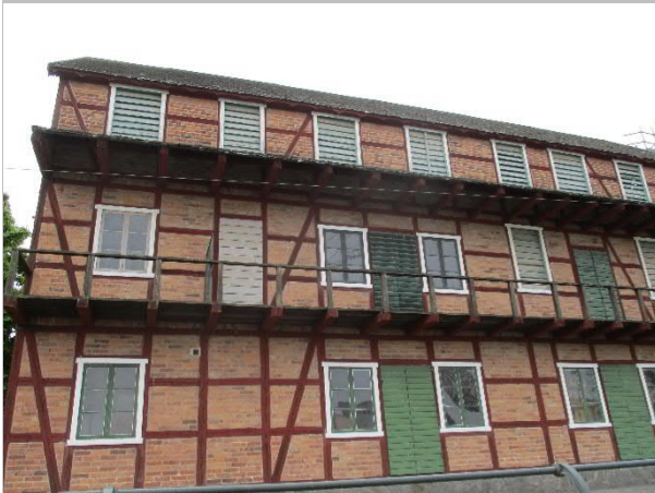
Nyare prov taget på fönsterkitt
