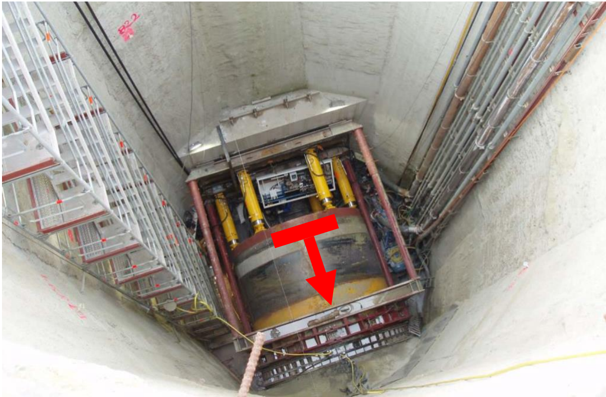
Figur 14 Matargrop/startschacht (s.k. jacking-station). Röd markering visar kraftens drivningsriktning. Källa: Projekt H3-4 Emschertunneln.
