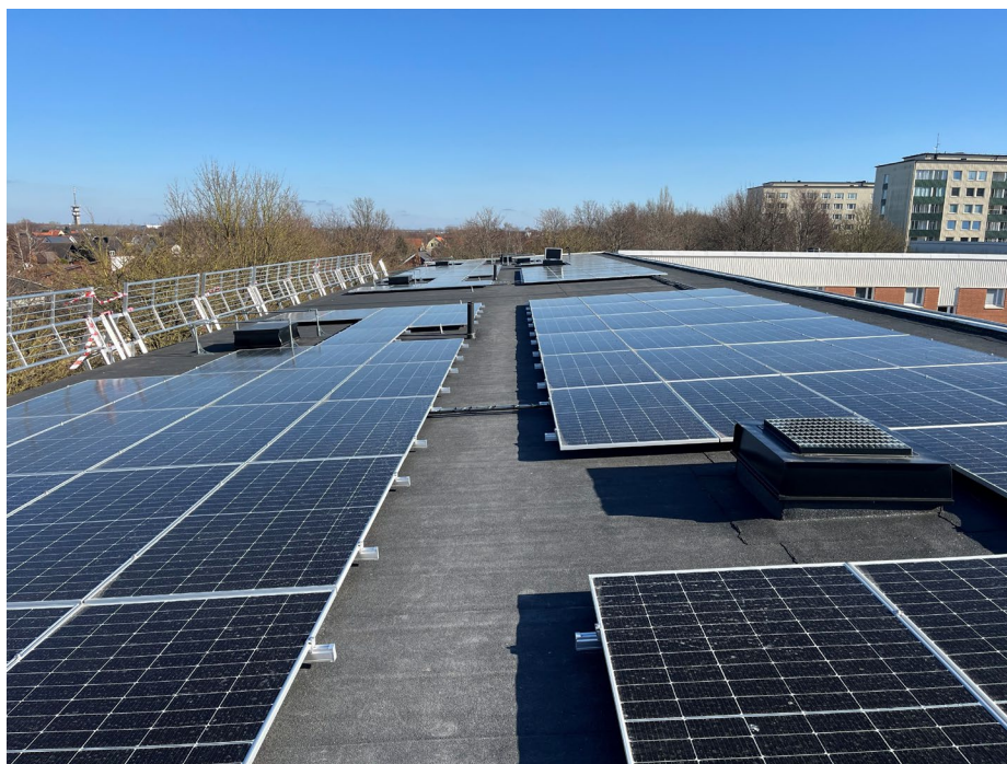
Figur 5. Solcellsanläggning monterad på taket till ett av MKB:s hus i Gullviksborg. Bild: MKB.
