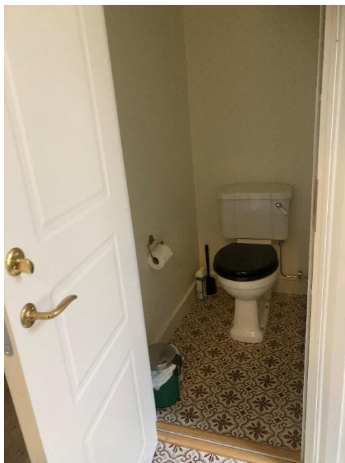
En av toaletterna som planeras att rivas. Dörr, golv och toalettporcelain från 2000-talet, om än anpassade.
