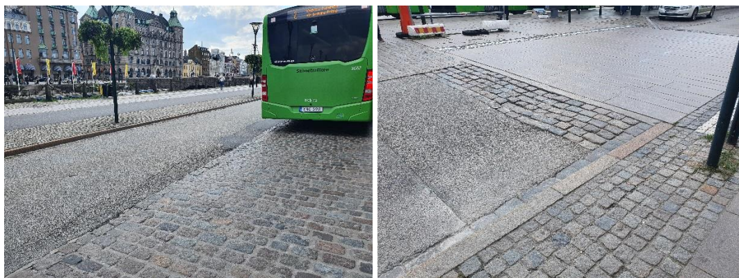
Figur 138. Till vänster: Ytskador och ojämnheter på Centralplans södra körbana. Till höger: Ytskador vid hastighetssäkerad passage på Centralplans södra körbana.
